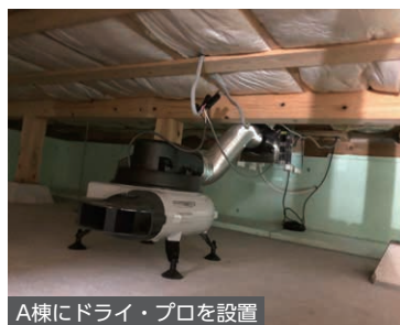
A棟にドライ・プロを設置
